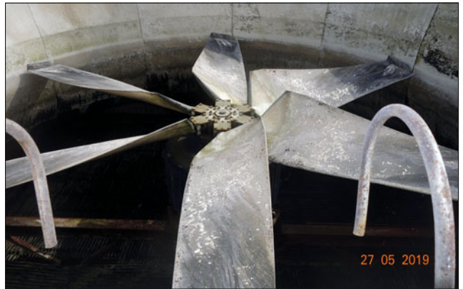
Рис. 4. Стеклопластиковые лопасти вентилятора № 4 градирни типа БМГ-1000
